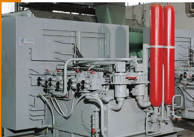
Impianto oleodinamico per geotermia
