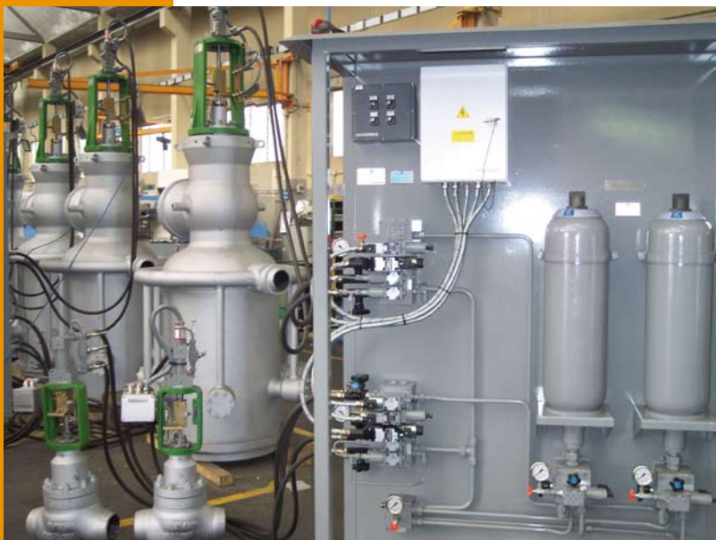
Valvole servocontrollate e pannello di comando oleodinamico
